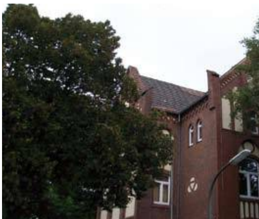
Schulmuseum – Dach vor der Sanierung
