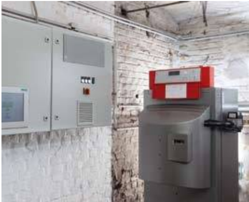
Schulmuseum – neue Wärmeregeler
