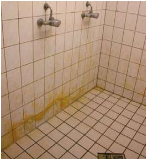
Sanitärräume vorher (Foto: Herr Kresse)
